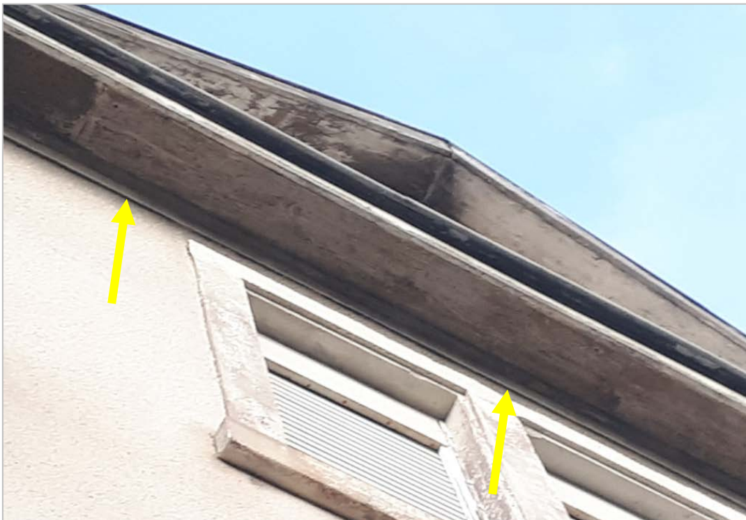
Abb. 8: Spalte zwischen Dachtrauf und Hauswand am Gebäude auf Flst. Nr. 207 (Blumenweg 7) (Aufnahmedatum: 19.09.2023)
