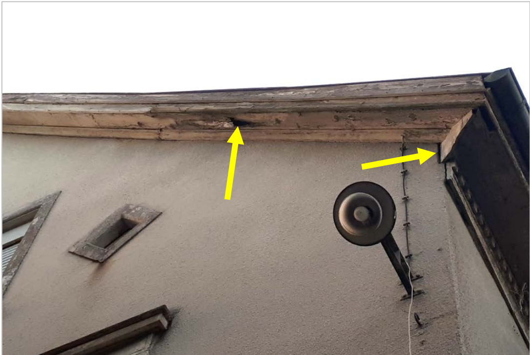
Abb. 7: Loch und Spalte im Dachtraufbereich am Südgiebel des Gebäudes auf Flst. Nr. 207 (Blumenweg 7) (Aufnahmedatum: 19.09.2023)
