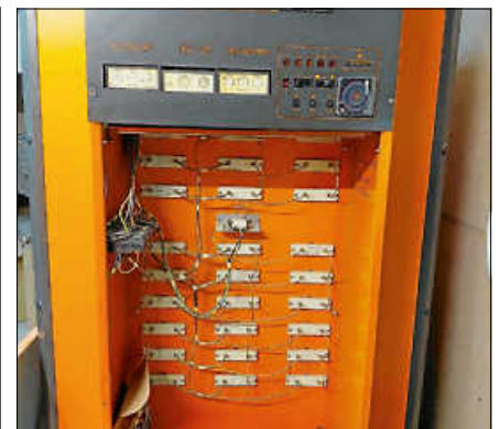
Anlage der Elektro-Blockspeicherheizung. Foto: Stadt Gernsbach
