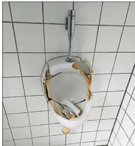
Regelrecht von der Wand geschlagen wurde das Pissoir.
