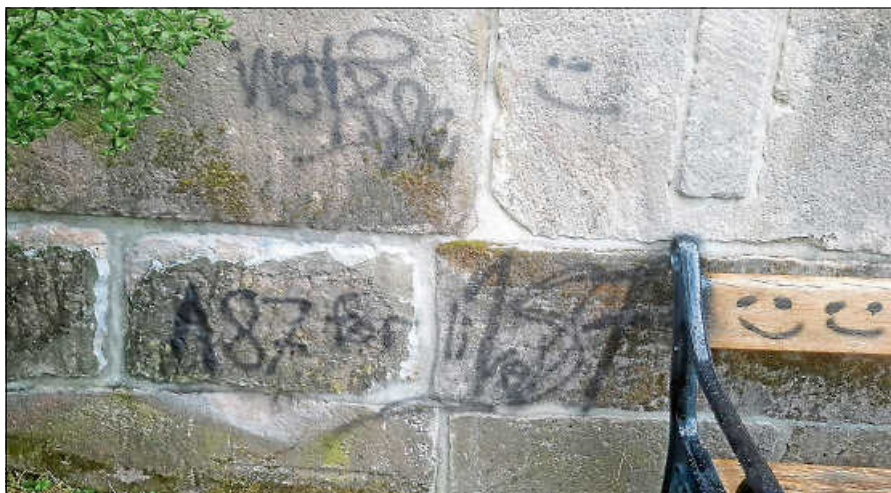
Schmierereien an der Sandsteinmauer.
