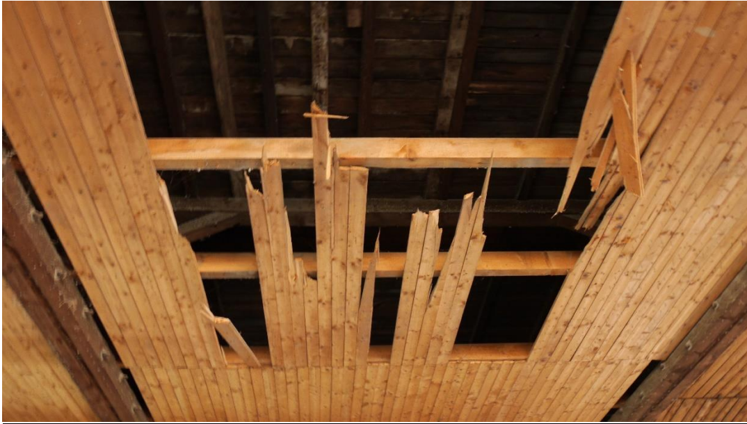
Photo 3: weggebrochene Verschalung, unbegrenzte Zuflugmöglichkeit
