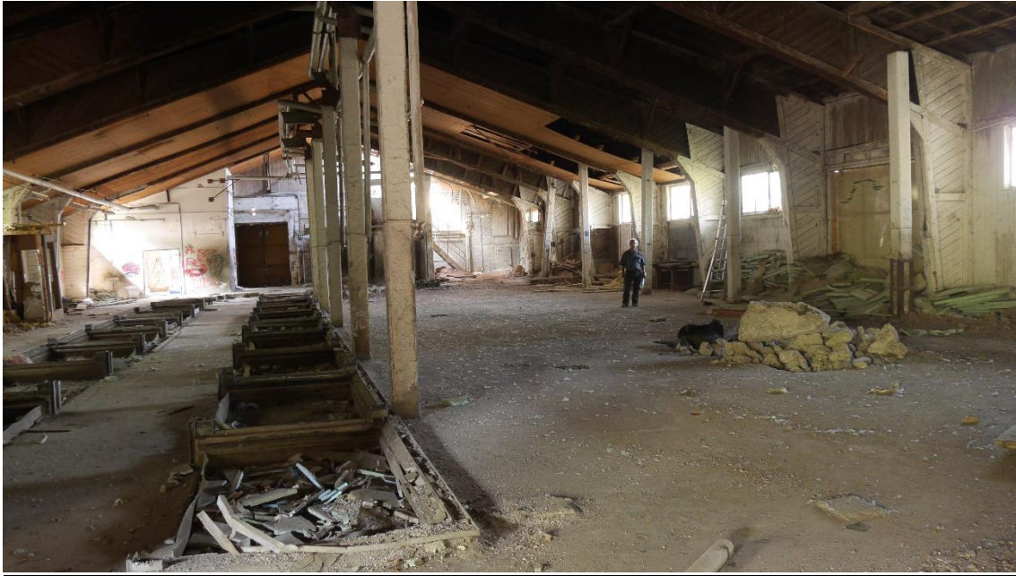
Photo 5: Standort Mitte mit großen Hohlräumen in Decke
