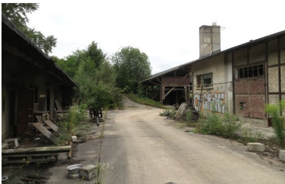
Bild 5: Verfallene Bausubstanz (Foto 2017)
