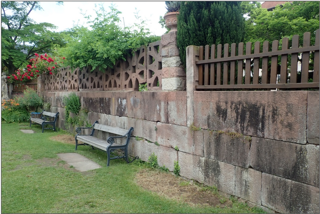
Abb. 4: Wasserseitige Mauerfugenspalten als relevanter Mauereidechsen-Lebensraum im Katz'schen Garten
